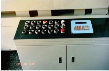
制御盤・操作SW
